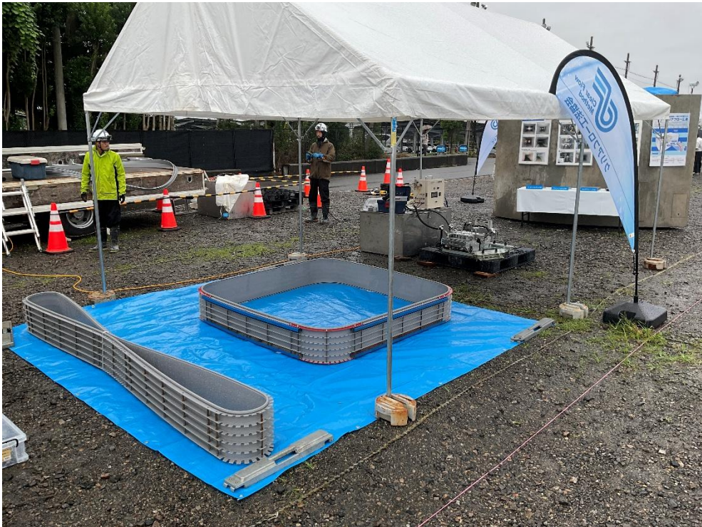
写真-2 クリアフローブース全景②
